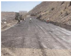
Aplicación de Geomalla Tencate Mirafi Miragrid XT para muro mecánicamente estabilizado en capa base.
