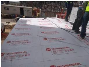
Aplicación de Aislante térmico XPS CARBON en subestación eléctrica, Ciudad de México (2021).
