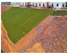
Aplicación de Geomalla Tencate Mirafi Miramesh para evitar erosión de patio industrial.
