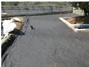
Aplicación de Geotextil no tejido Tencate Mirafi Series N, separación de suelo y geomembrana PVC para azotea ajardinada, Bosque de las Lomas (2020).
